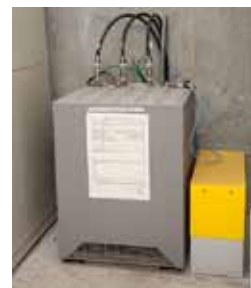
塔屋内に設置された コンパクトな基地局設備
