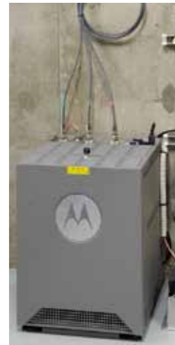
コンパクトな基地局設備
