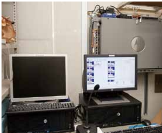
役場に設置された回線制御装置と統制台
